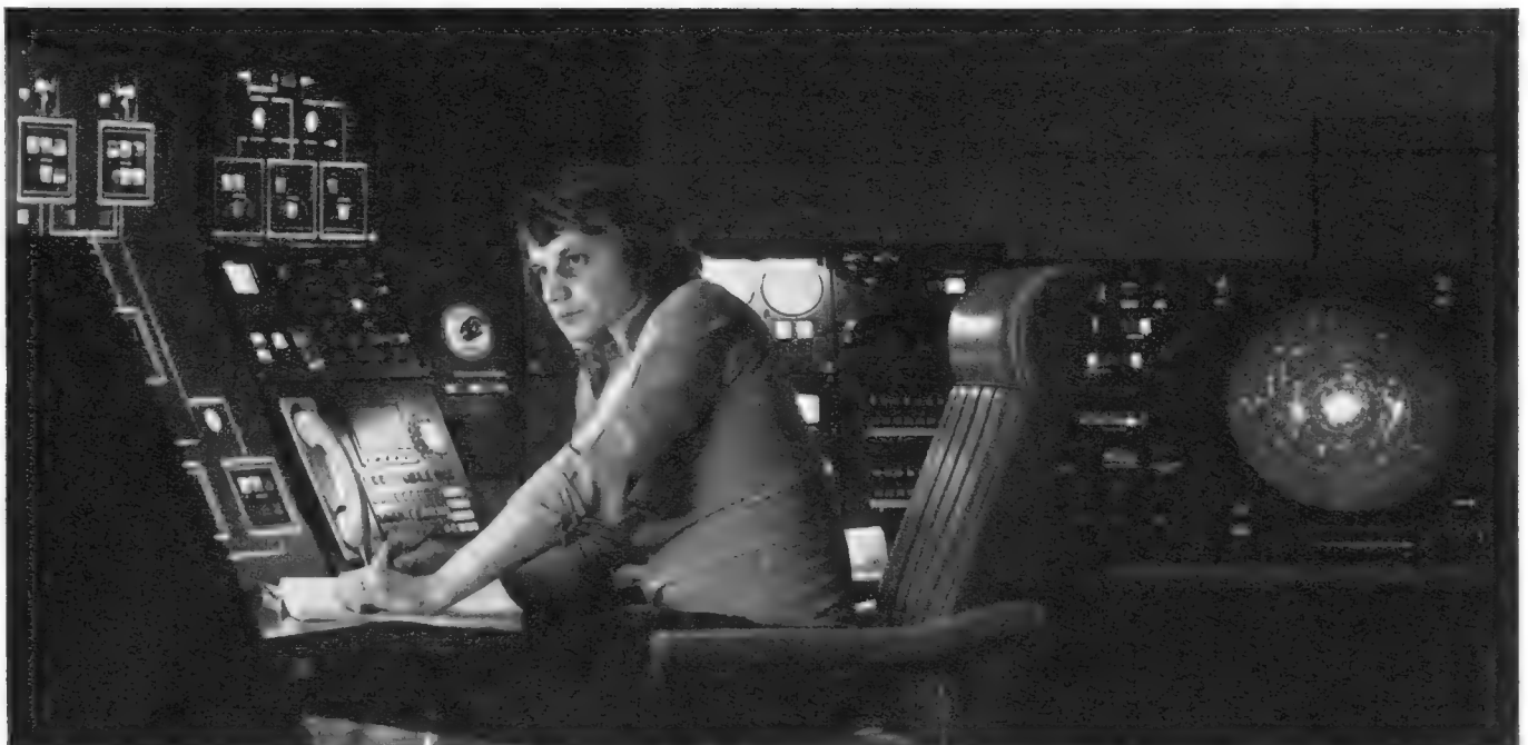
Von den 48 Primär- und Sekundär-Radaranlagen für die Flugsicherung im Bundesgebiet hat AEG-Telefunken 45 geliefert. Im Bild: Steuer- und Überwachungspult der Mittelbereichs-Radaranlage SRE LL 1 im Pfälzer Wald. Das Gerät dient zur Überwachung des mittleren und oberen Luftraumes
